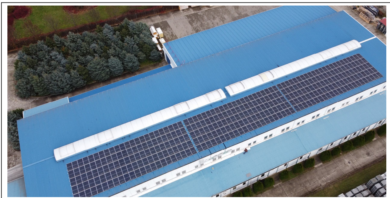
113,90 kW teljesítményű napelemes rendszer
